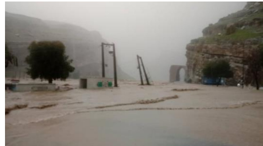
شکل (۱): بخشی از خسارات وارده به شبکه توزیع برق پلدختر در اثر سیل
